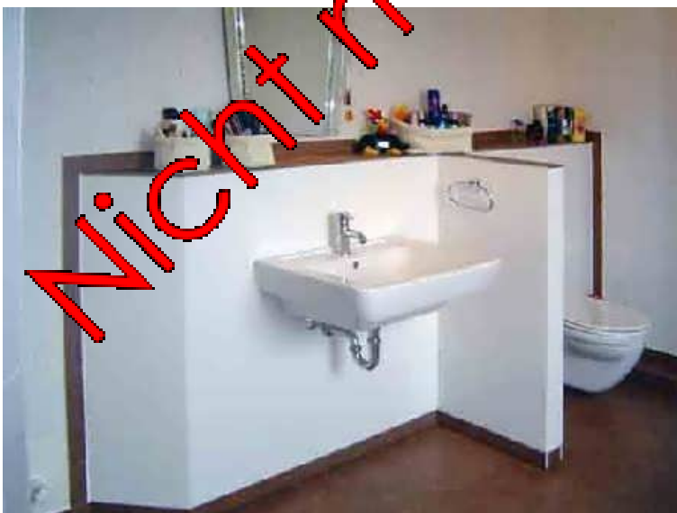
Waschbecken u. WC
